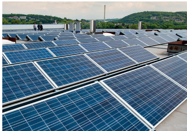
In Wuppertal gibt es bereits mehrere große PV-Anlagen. Die WSW unterstützen die Betreiber bei der Vermarktung, so dass auch Privatkunden den dort erzeugten Strom nutzen können.
