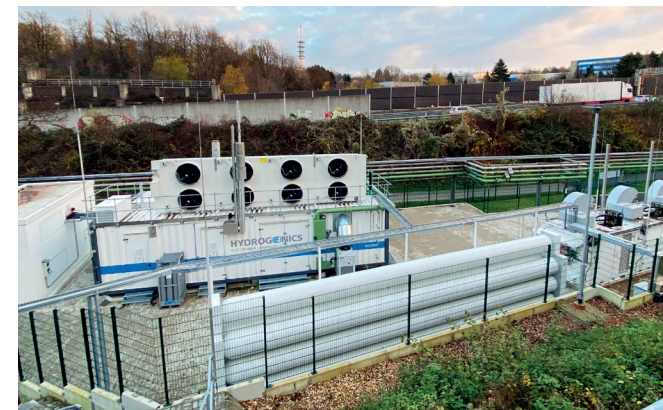
Die Wasserstoff-Produktionsanlage bei der AWG.
