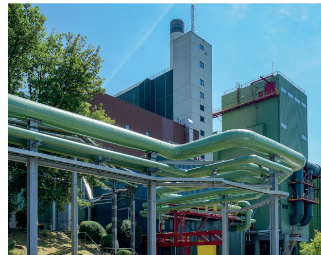
Im Müllheizkraftwerk der AWG wird bei der thermischen Abfallbehandlung Strom und Fernwärme erzeugt. Der Strom wird auch für die Elektrolyse genutzt.
