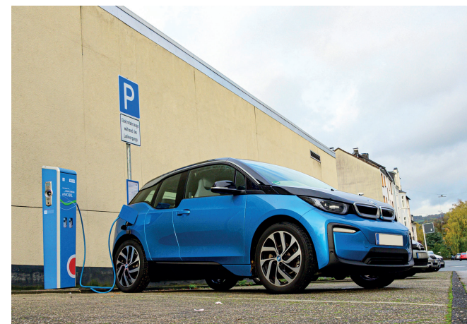
Durch die kontinuierliche Verbesserung der öffentlichen Ladestationen unterstreichen wir unser Engagement für die Förderung der Elektromobilität.
